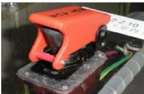
Рабочее состояние переключателя S2/S3 в процессе движения
